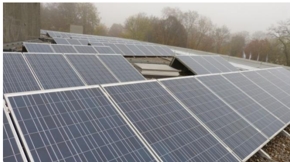
PV-Module auf der Kongresshalle
