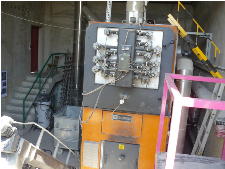
Heizkessel der Biomasseheizanlage im Botanischen Garten
