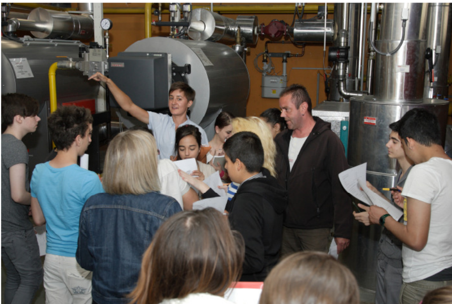
Jobs mit Zukunft: Besichtigung des Heizungskellers mit Experten
