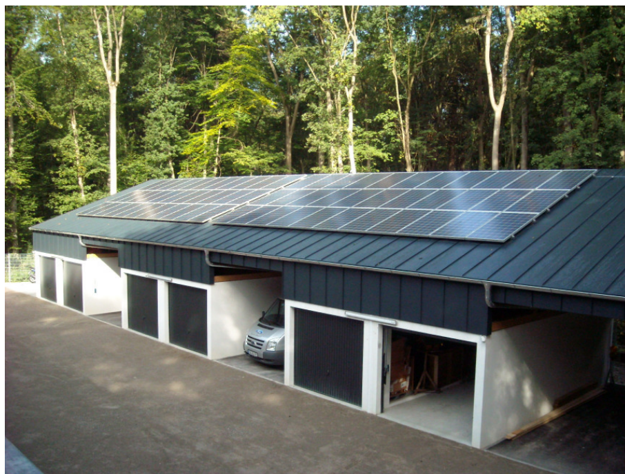
Neue Photovoltaikanlage auf den Garagen des Bundesleistungszentrums für Kanusport
