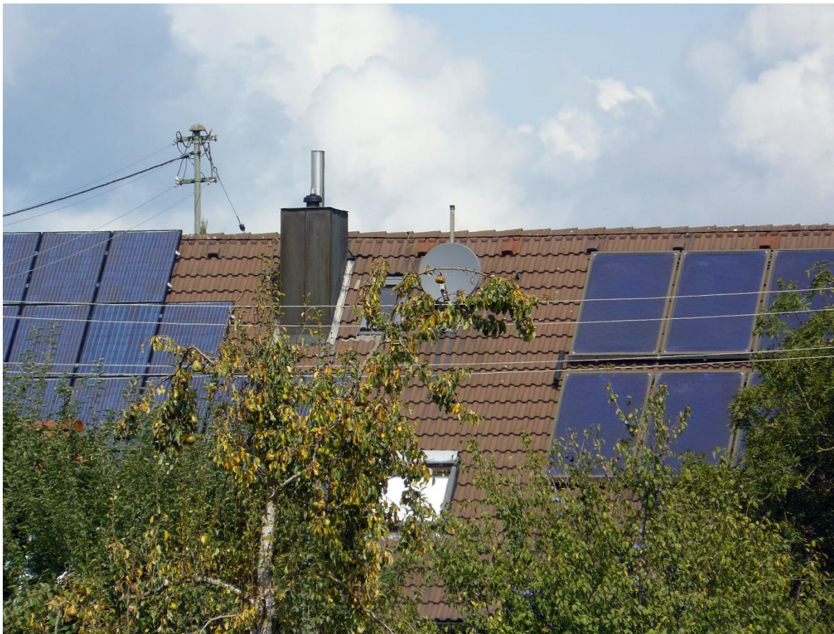
Dach in Augsburg mit PV-Modulen und Solarkollektoren, Bild: Ralf Bendel
