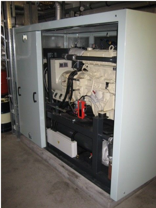
Blockheizkraftwerk der Stadtwerke Augsburg Energie GmbH in der Friedrich-Ebert-Schule (Augsburg-Göggingen), Heizraum
