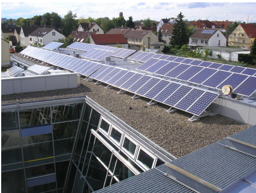
PV-Investorenanlage (92 kWp) der Fa. Fagus Energieprojekte GmbH auf der Pankratiusschule in Augsburg-Hochzoll
